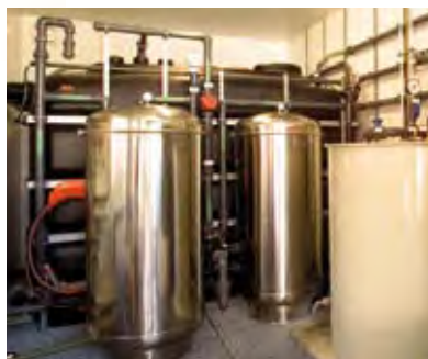
Wasseraufbereitungsanlage, spart Energieressourcen und schützt nachhaltig die Umwelt.
